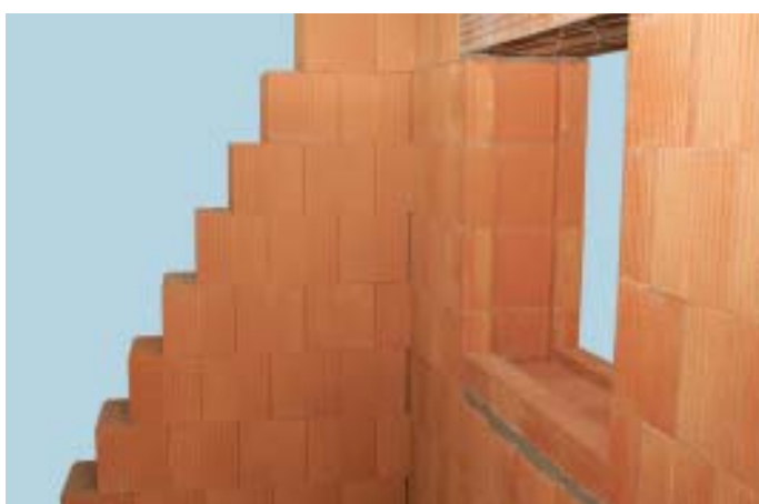
Pohľad na hotový okenný otvor – po troch stranách otvoru je súvislá kapsa pre tepelnú izoláciu
